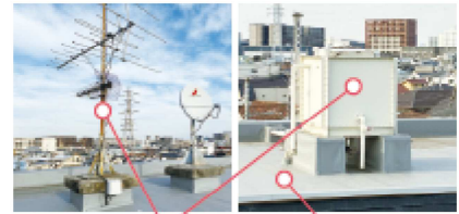
屋上設備 (通信設備・高架水槽)
